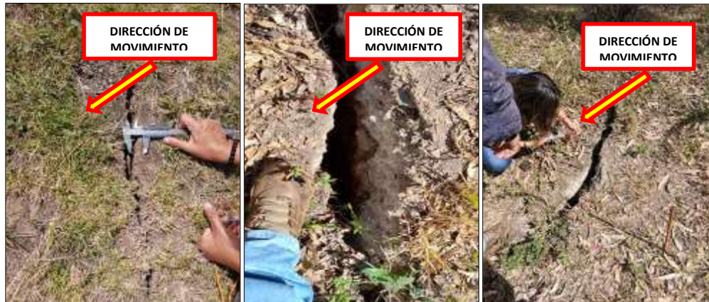
Fotografía 1. Imágenes de grietas G1 en sector circundante a la piscina de oxidación.
