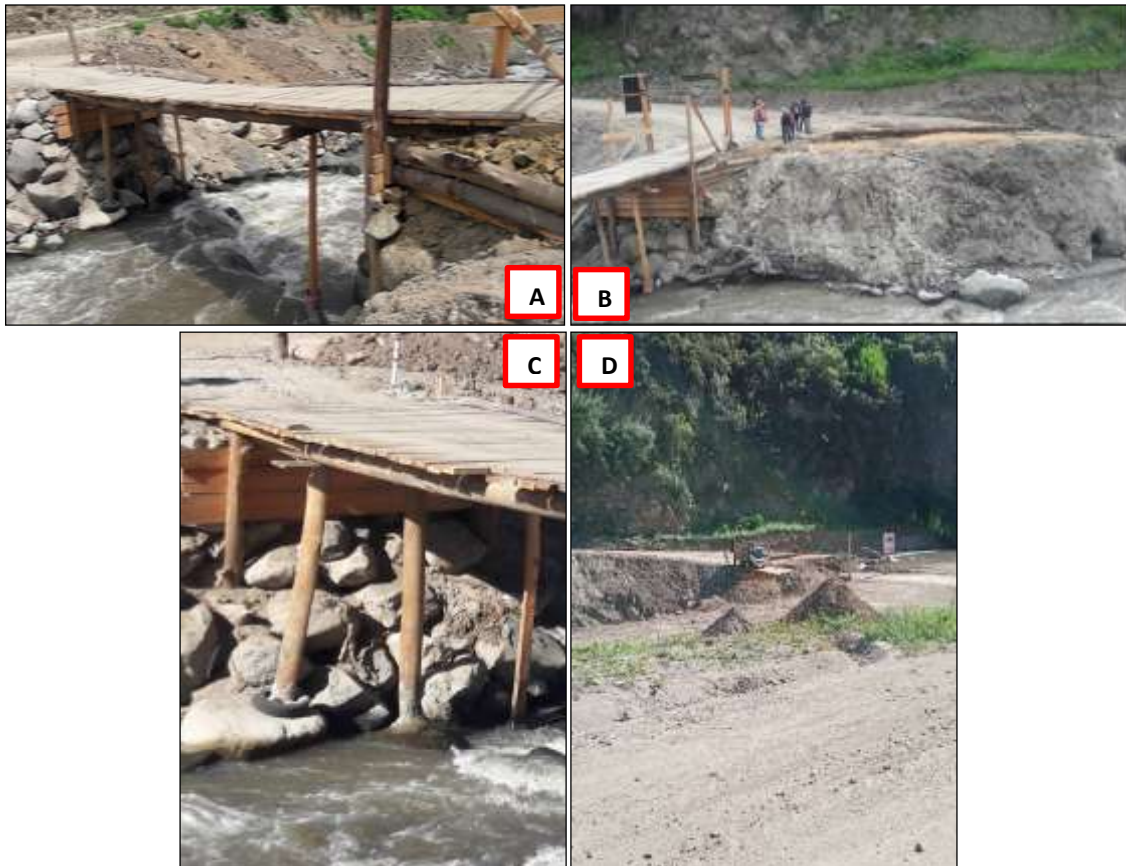
Fotografía 5. A) Puente implementado de manera antitécnica; B) Estribo derecho del puente sobre un relleno de lodo; C) Construcción de apoyos simples sobre las rocas, D) Vehículo de carga no permitido para el uso del puente.
