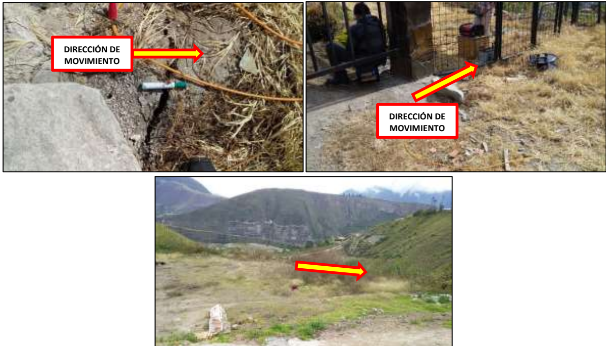
Fotografía 4. Imágenes de grietas G4 en el sector La Gallera.
