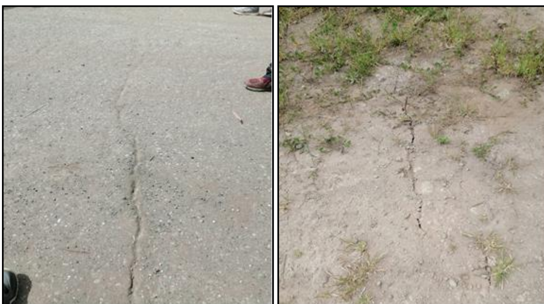
Fotos 7 y 8: Imágenes de grietas en el sector del antiguo botadero.
