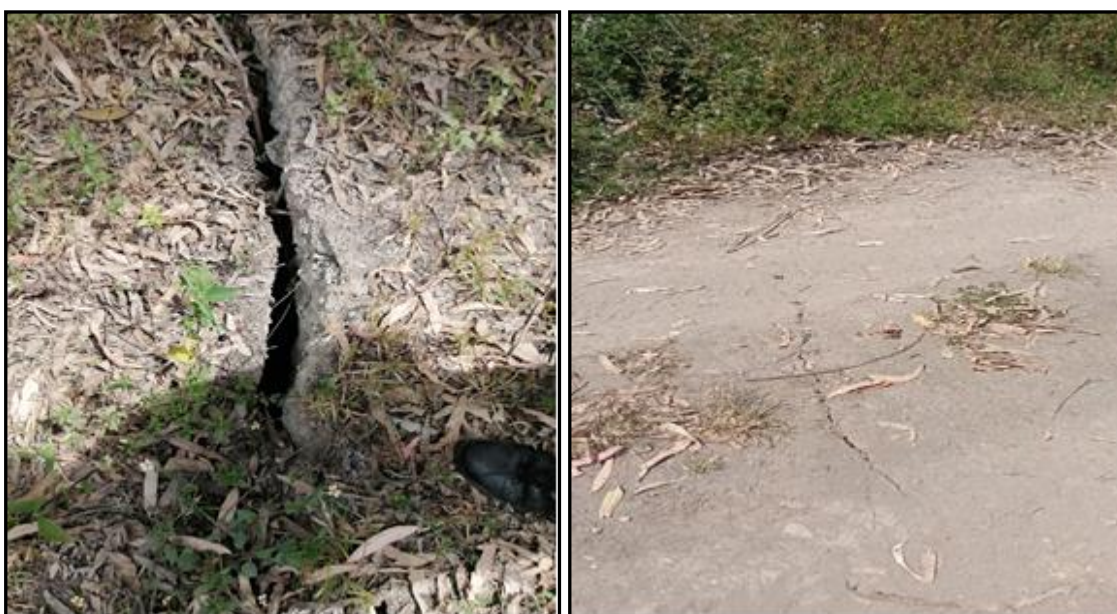
Fotos 5 y 6: Imágenes de grietas en el sector de las viviendas.
